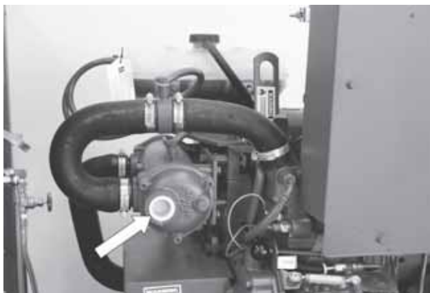
Фиг. 22 Изход на топлообменника
